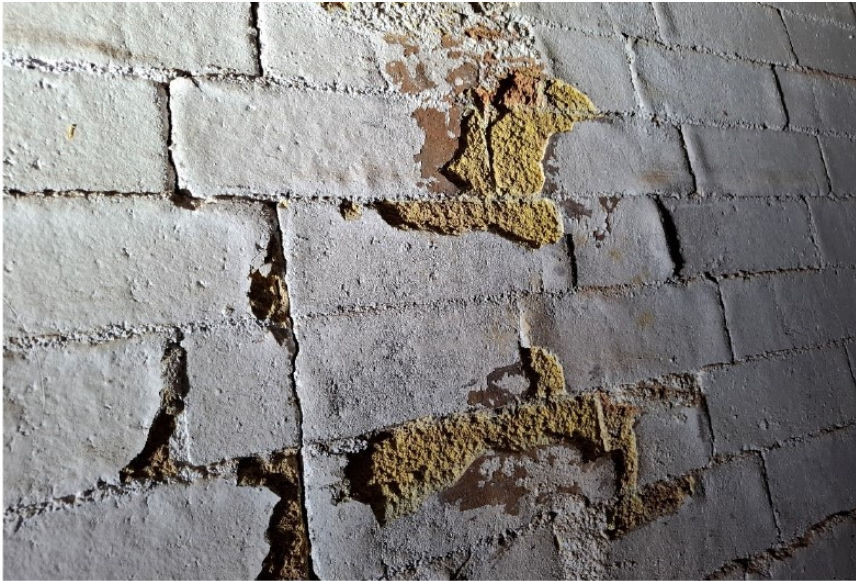
Lokales Abplatzen des Feuerfestmaterials
