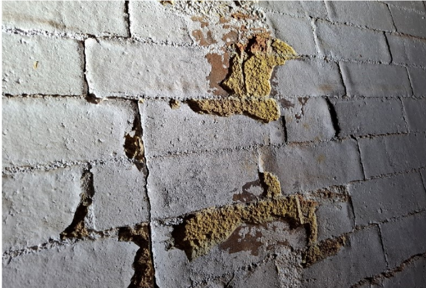
ÉCAILLAGE LOCAL DU MATÉRIAU RÉFRACTAIRE
